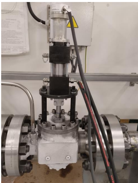
Рис. 4. Внешний вид запорно-регулирующего клапана по месту его монтажа в составе СВС
