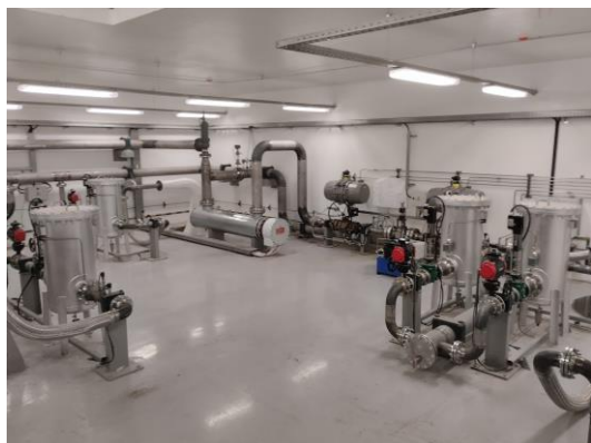
Рис. 2. Общий вид оборудования системы воздухообеспечения, установленного в помещении генераторов звука и рупоров
