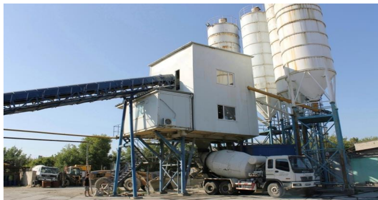
Рис. 1. Бетонный узел предприятия ООО "ДСК"
