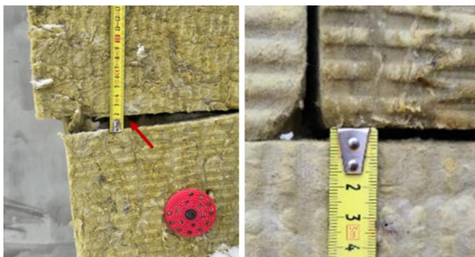
Рис. 6. Зазор между плитами утеплителя
