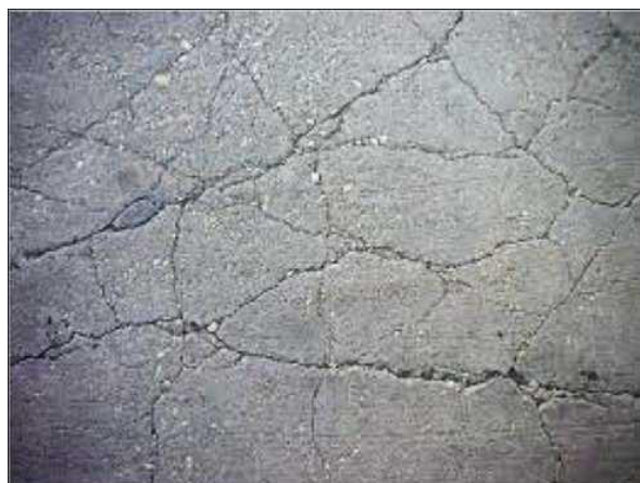
Рис. 1. Трещины на поверхности асфальтобетонного дорожного покрытия
