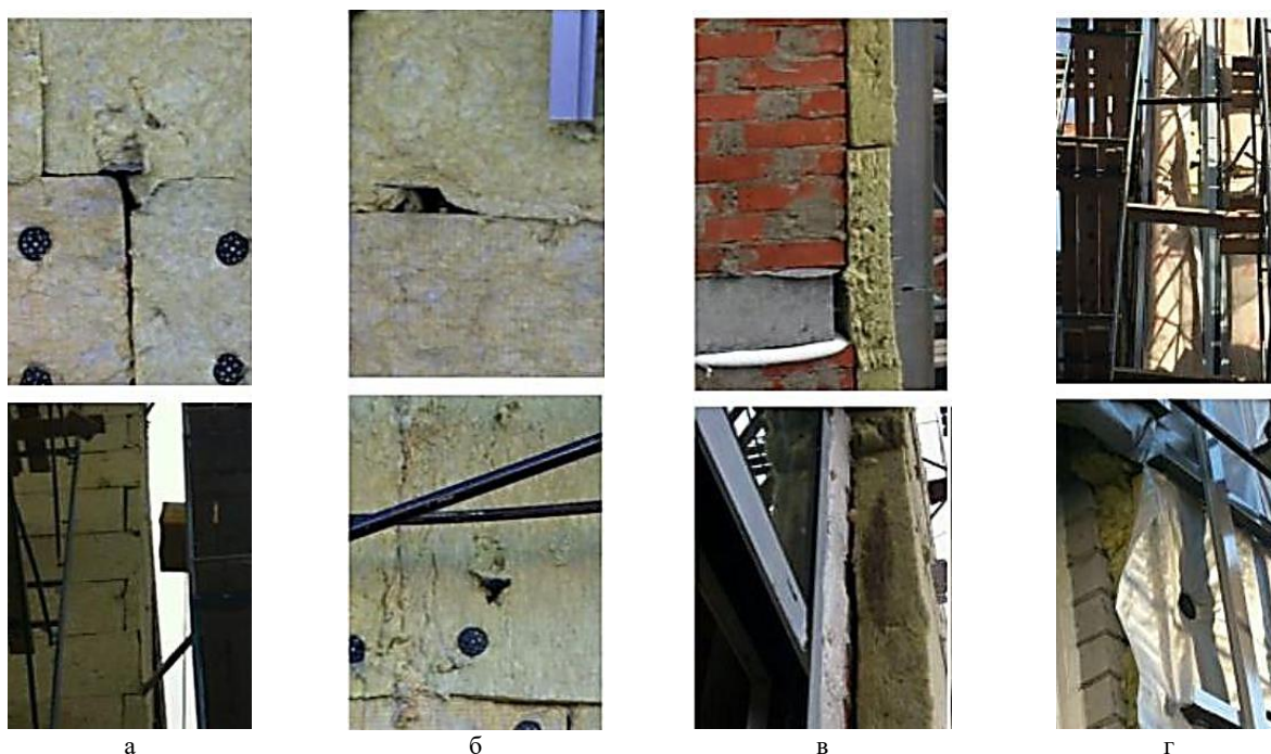
Рис. 3. Нарушения технологии устройства теплоизоляционного слоя
