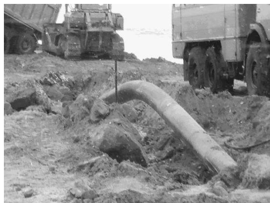
Рис. 1. Продольная потеря устойчивости вскрытого трубопровода
