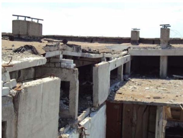
Рис. 2. Повреждения после обстрела жилого дома в г. Первомайск по адресу: ул. 60 лет образования СССР, дом 11
