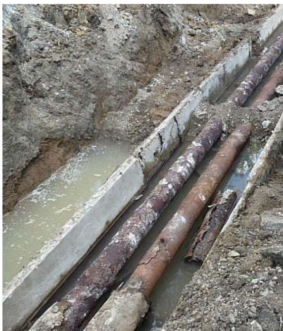
Рис. 5. Разрушение теплотрассы в результате подтопления и заноса грунтом
