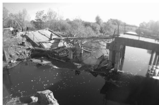
Рис. 3. Состояние дороги Р-07 и мост через р. Айдар у с. Старый Айдар (разрушен в 2014 г.)
