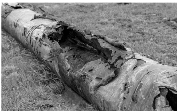
Рис. 4. Локальный характер наружной коррозии
